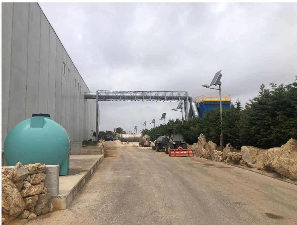
Figura 7: vista tubazione di aspirazione
