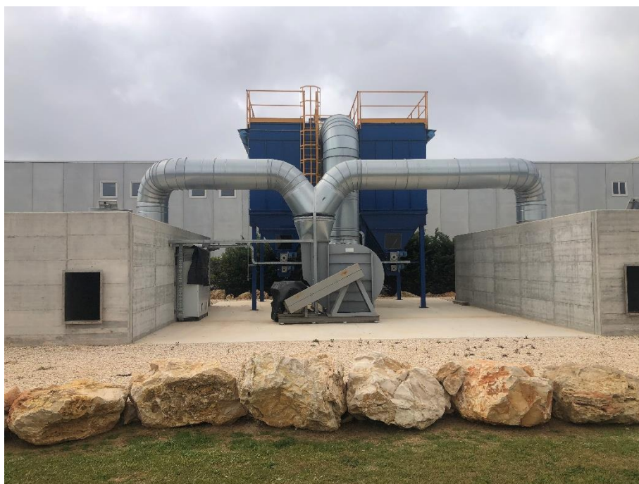
Figura 8: vista filtro a maniche e tubazioni invio a biofiltro
